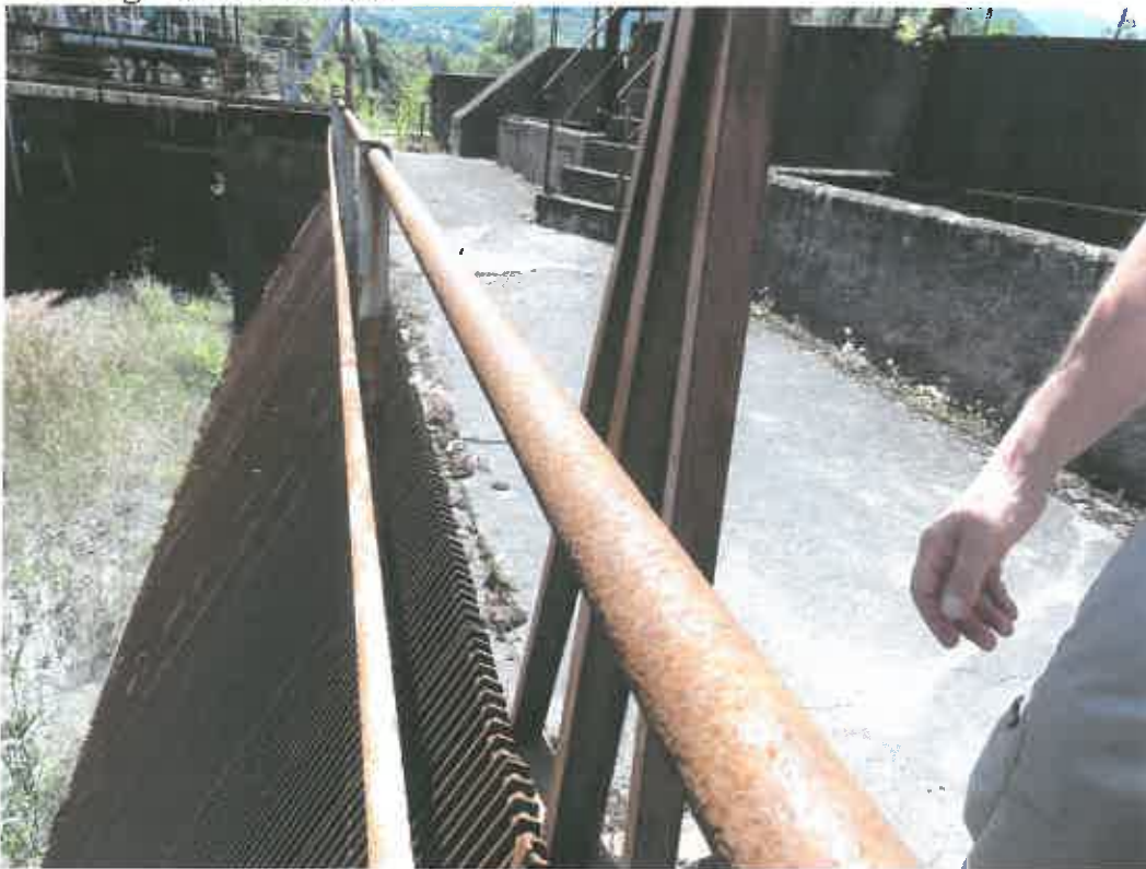
La grille de dégrillage
