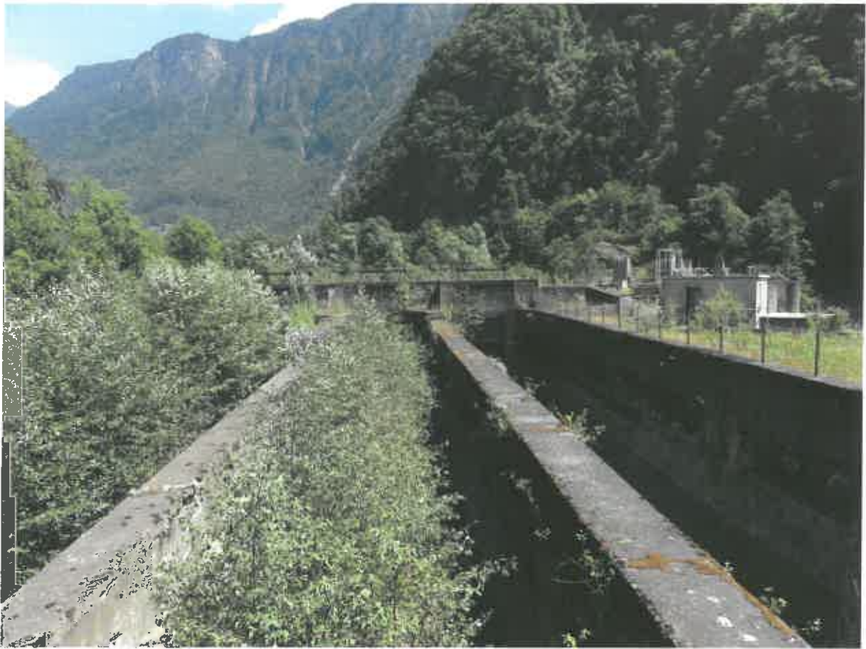
Les bassins de décantation
